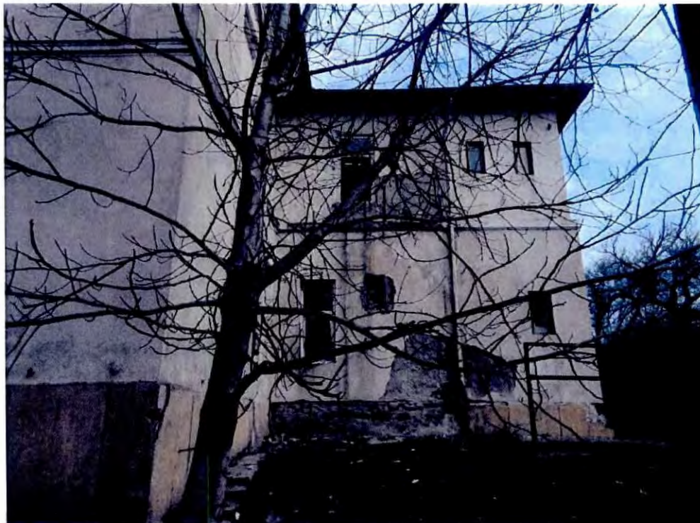
Infiltrații, fisuri, crăpături, desprinderi de tencuială
