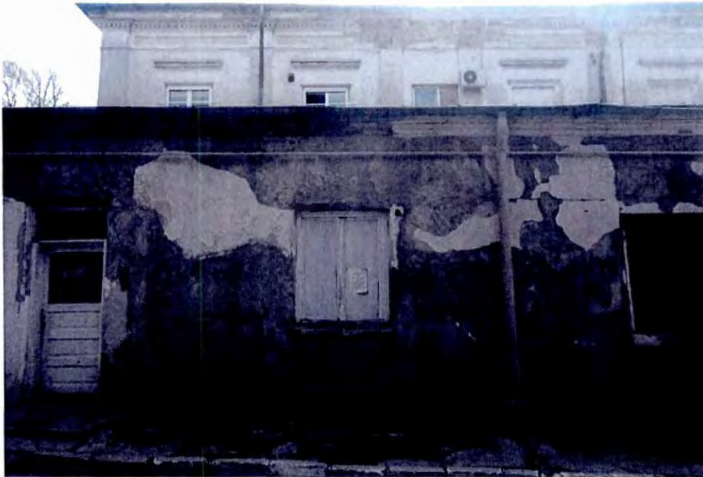
Fisuri, crăpături, desprinderi de tencuială
