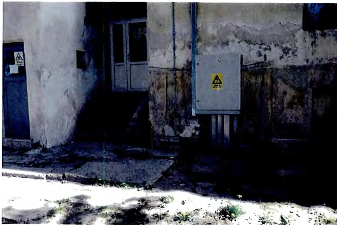
Degradarea trotuarelor și a scărilor de acces
