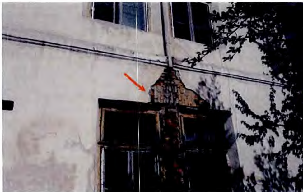
Degradarea accentuată a zidăriei datorită desprinderii tencuielilor cauzate de lipsa burlanelor
