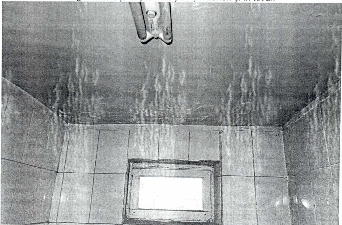
Fig.10: Zone degradate din interiorul clădirii
