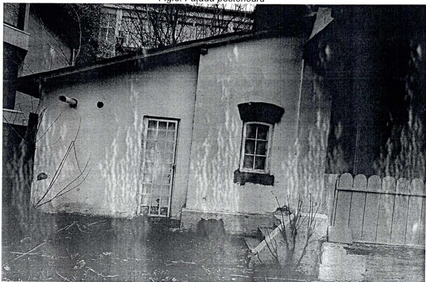
Fig.4: Degradări la nivelul tencuielilor exterioare
