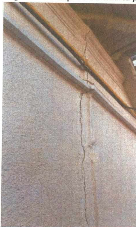
Foto 10 –Fisuri între pereții de argila nearsă (chirpici) și pereții de cărămidă adăugați ulterior
