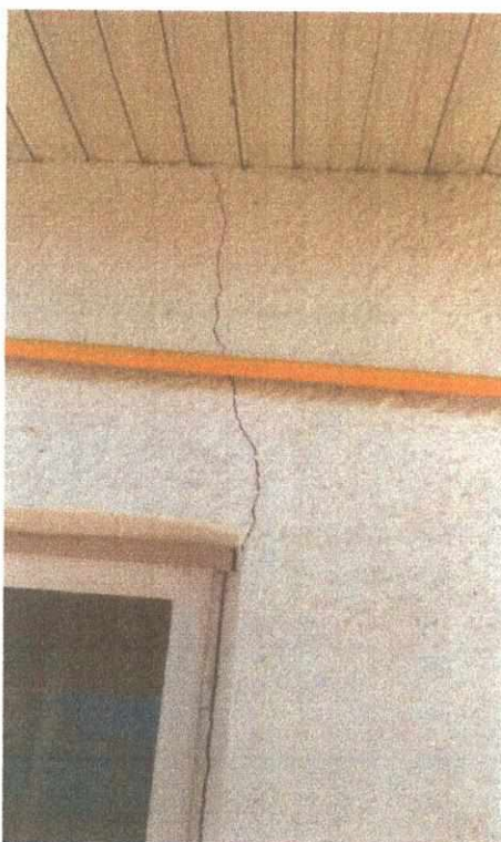
Foto 13 – Fisuri in peretii clădirii
