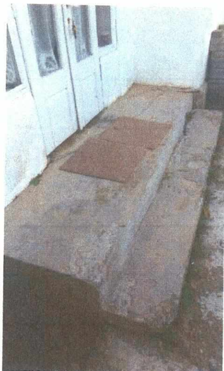
Foto 9 –Degradări ale treptelor la intrarea principală
