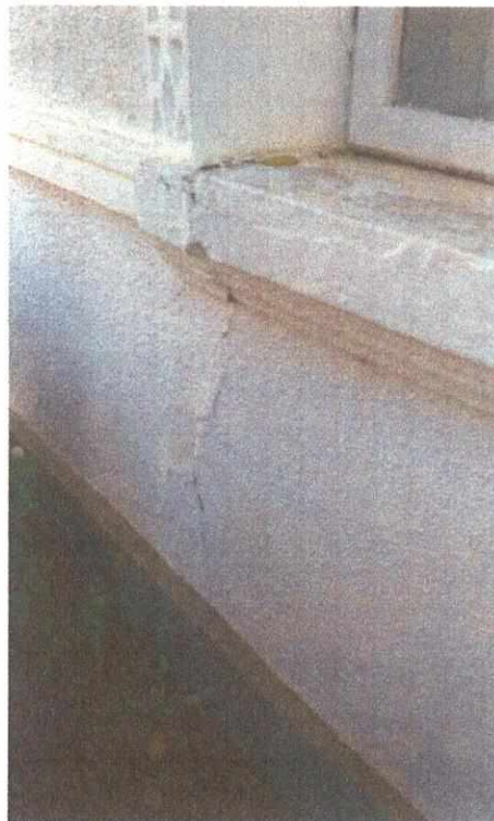
Foto 8 – Fisuri in pereții clădirii
