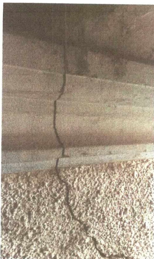
Foto 17-Fisuri in pereții clădirii
