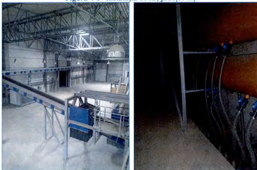
Figură 4-17 Instalația TMB, județul Iași
