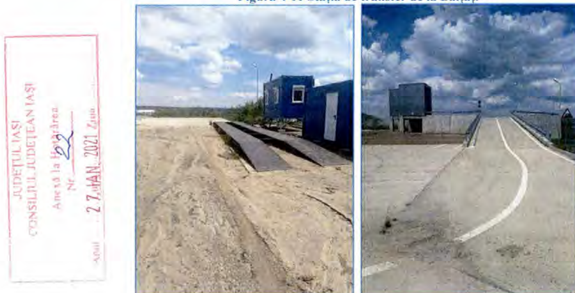
Figură 4-11 Stația de transfer de la Bălțați
