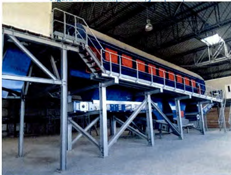
Figură 4-16 Instalația TMB, județul Iași
